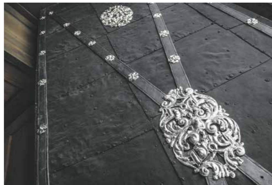
Jedním z nejcennějších prvků kostela jsou vstupní dveře, které se musely kvůli restaurování vysadit a odvést do dílny restaurátora Petra Jandy
